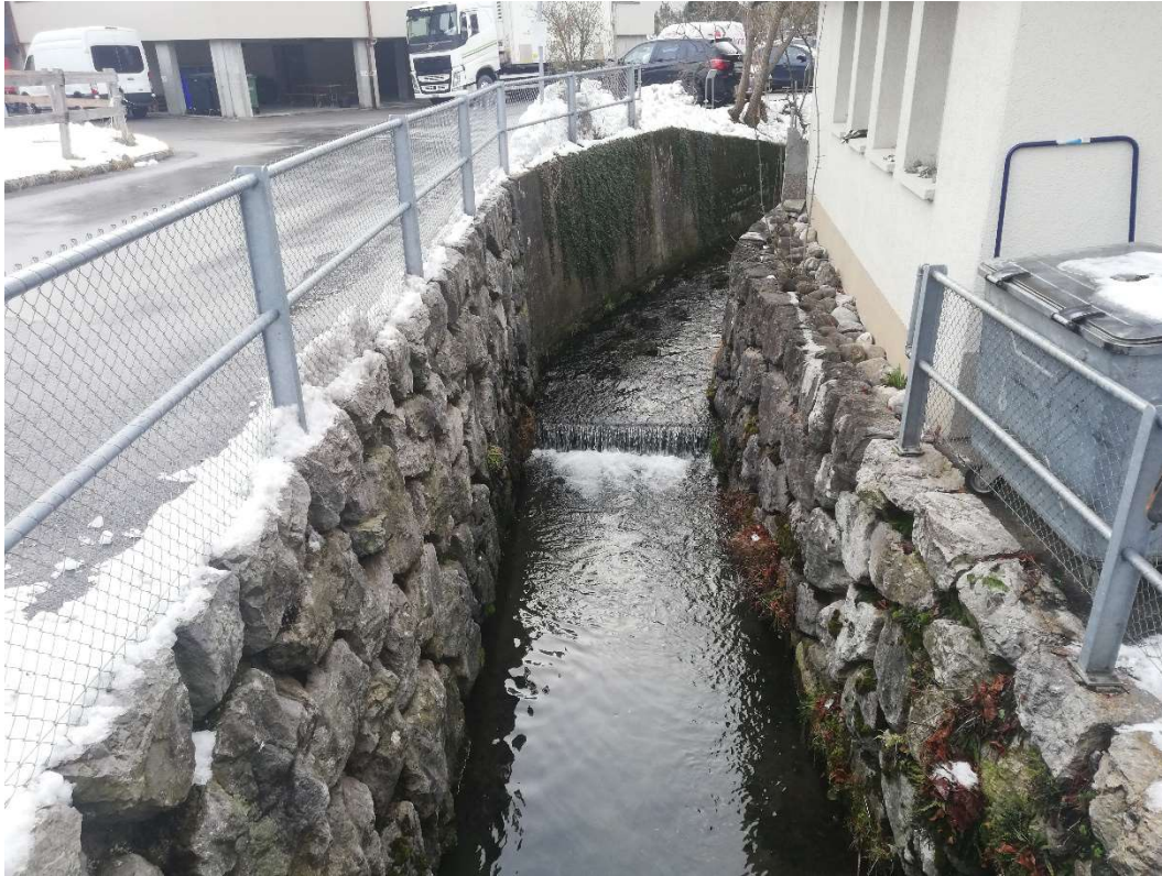
Abbildung 7: Dorfbach, oberhalb Brücke Bahnhofstrasse, Blick gegen Fließrichtung. Stark kanalisiert, fehlende Breitenvariabilität, Foto vom 19.12.2022
