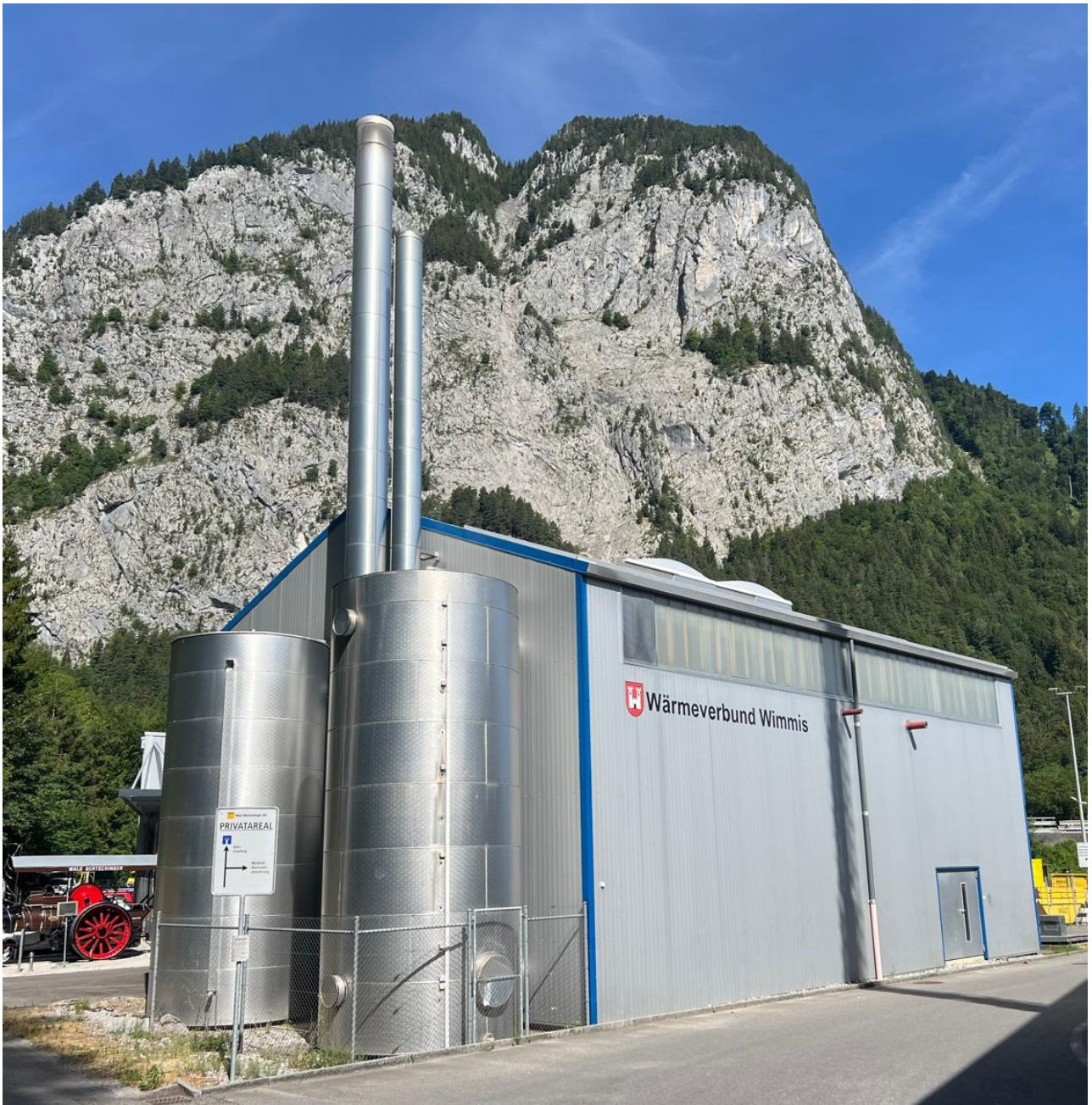
Heizzentrale mit Wärmespeichern an der alten Staatsstrasse
