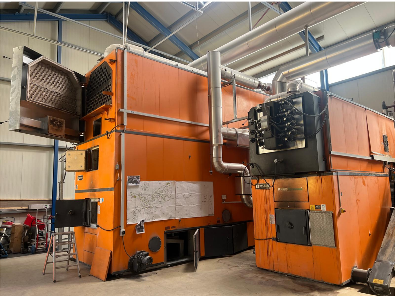
Holzfeuerungen Schmid 2'400 kW und 900 kW
