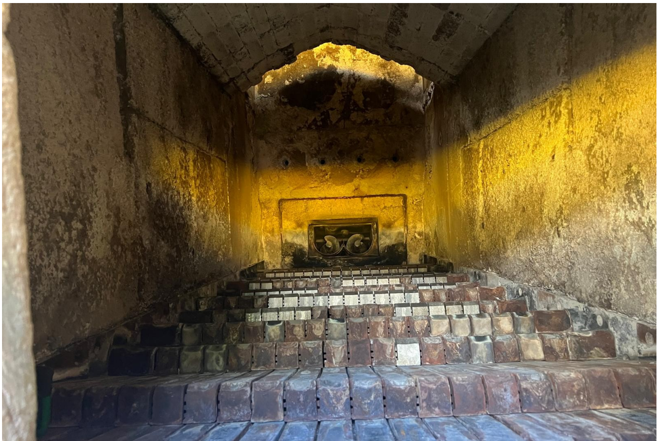
Brennraum Holzfeuerung 2'400 kW
