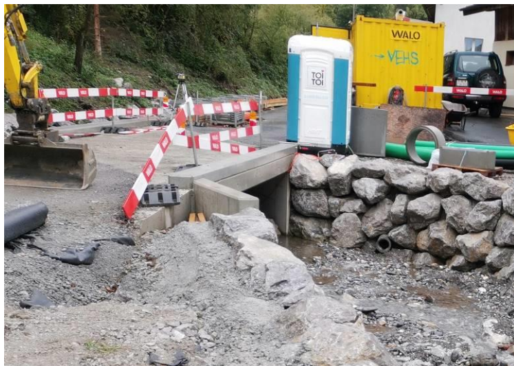
Grösserer Durchlass Dorfbach
